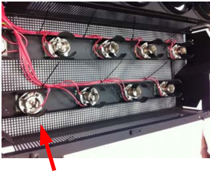
Passage des câbles (1 & 6 par la droite, les autres par la gauche)
